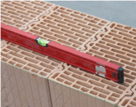
17. Kontrola steny vodováhou
